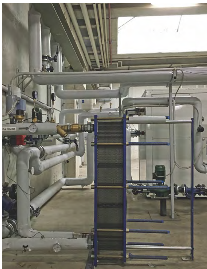
La RETINA installata nello stabilimento ArcelorMittalCLN produce i fluidi per la climatizzazione invernale ed estiva della palazzina e copre l'intero fabbisogno di ACS dello stabilimento, per tutti i tre turni di lavoro.
